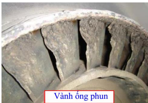
Hình 3. Cánh ống phun bị mài mòn và cong vênh.
