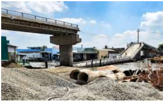
Hình 2. Sập Cầu Cái Đồi Vàm (Cà Mau)
