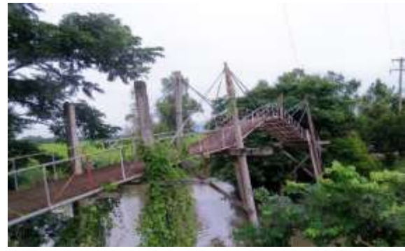
Hình 5. Cầu Kênh 10 – Cần Thơ bị xiêu vẹo gây mất an toàn (An Giang)
