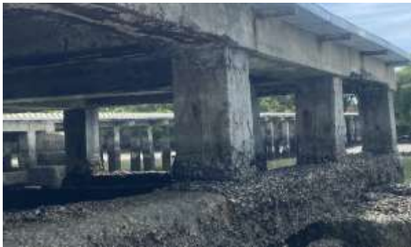
Hình 1. Hư hỏng của công trình biển khảo sát thực tế tại khu vực Vũng Tàu
